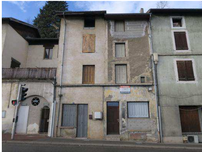
16-16b rue du Faubourg Vinay - Façade avec enduit altéré, volets pliants métalliques, devanture disparue
