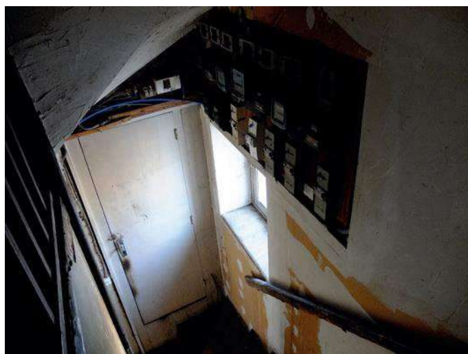
Retournement de l'escalier droit pour distribution du second et du troisième niveau
