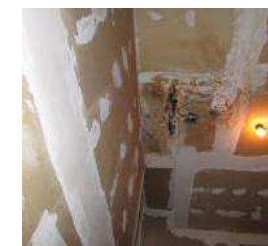
Etat des murs et planchers
