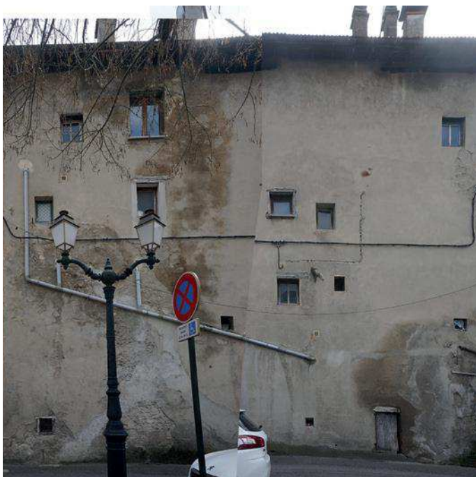
Façade arrière du 34 boulevard Gambetta. Le rez-de-chaussée et le premier niveau, où demeure le rempart, ne sont presque pas percés. Au contraire, les deux niveaux en surélévation sont dotés de nombreuses ouvertures.
