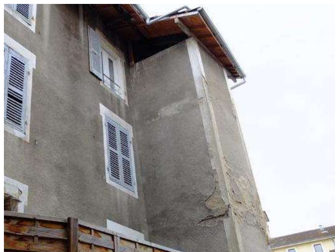
11 rue de France - Façade arrière altérée : enduit dégradé, manque un volet, fenêtre PVC avec des montants larges
