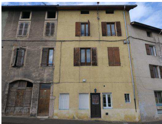
12 rue du Faubourg Vinay - Façade avec enduit non qualitatif, volets non persiennés, fenêtres sans partition, rez-de-chaussée sans composition
