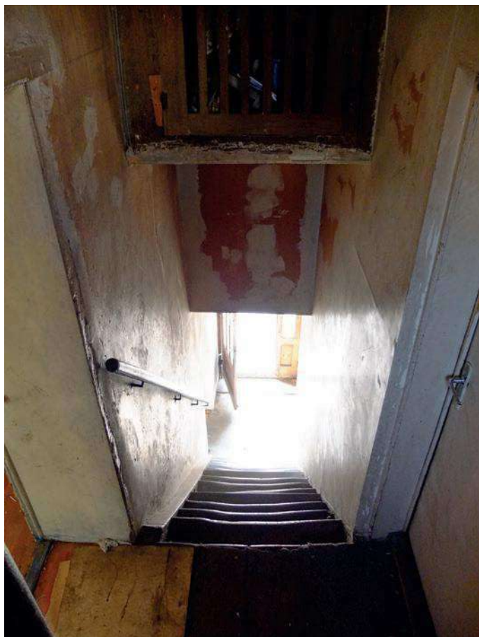
Escalier droit en bois, mauvais état général
