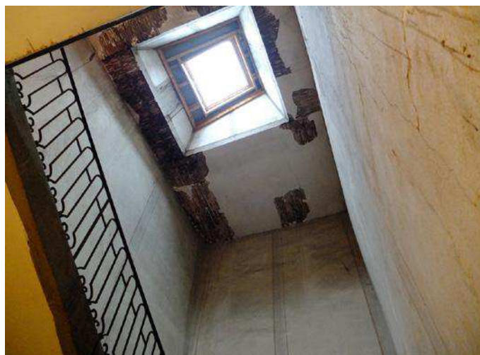
40 Grande Rue - Altération par défaut d'entretien des toitures, disparition des décors peints, péril des structures
