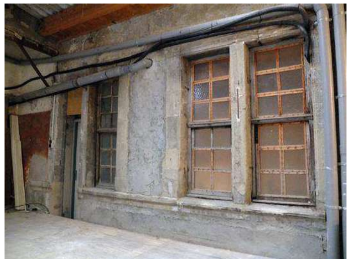
53 Grande Rue - Ancienne façade sur cour après fermeture, passage sauvage d'éléments techniques
