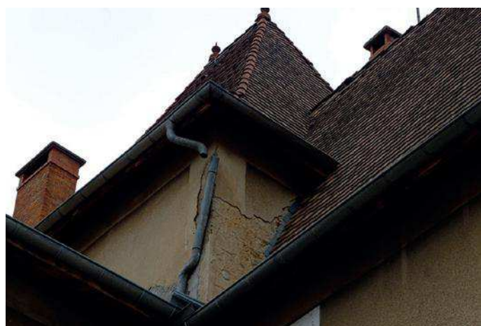
Château - Elévation sur cour - Enduits et décors anciens, dégradations en raison de mauvais raccordements
