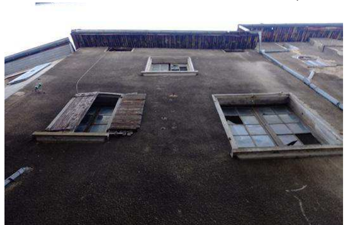
44 Grande Rue - Façade sur rue de Garagnol (partie gauche) - Nombreuses reprises des baies
