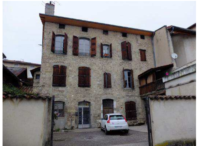
57 Grande Rue - Façade arrière largement altérée : disparition des décors enduits et peints, disparition des menuiseries anciennes, volets non entretenus, ajout d'éléments de serrurerie, adossement d'édicules, modification des percements, disparition des garde-coprs en fer forgé...
