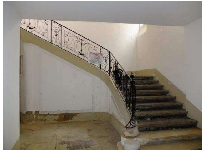
57 Grande Rue - Escalier suspendu à 2 volées et quart tournant, garde-corps en fer forgé
