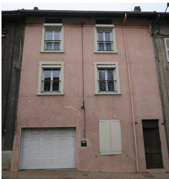
7 rue de la République - Enduit non approprié, volet roulant en applique, fenêtre PVC, réseau apparent
