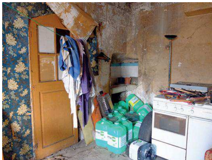
Cuisine créée dans une niche percée dans l'épaisseur du rempart au premier niveau
