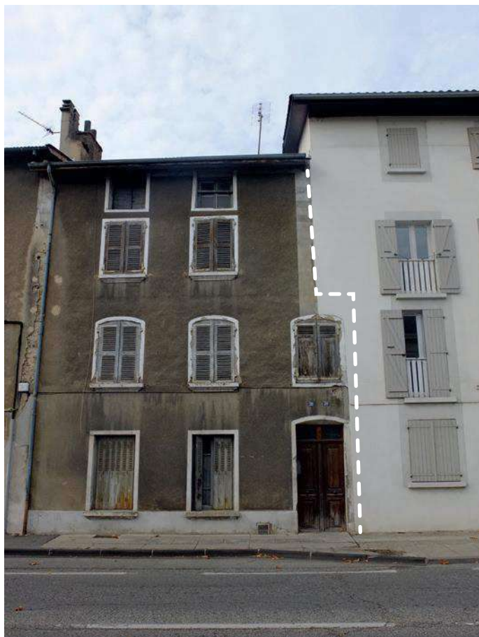
Façade principale sur cours Gambetta Lisibilité de la surélévation par différenciation des linteaux, vestiges de décors peints Déport du mur mitoyen
